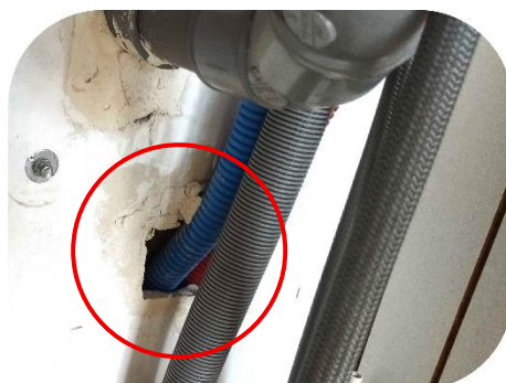
Passage réseau non étanché sous évier cuisine RDC
