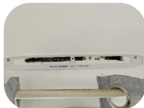
Mortaise entrée d'air non conforme sur caisson VR
